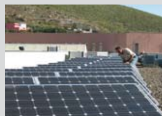
Deutsche Schule, Teneriffa, 88kWp
